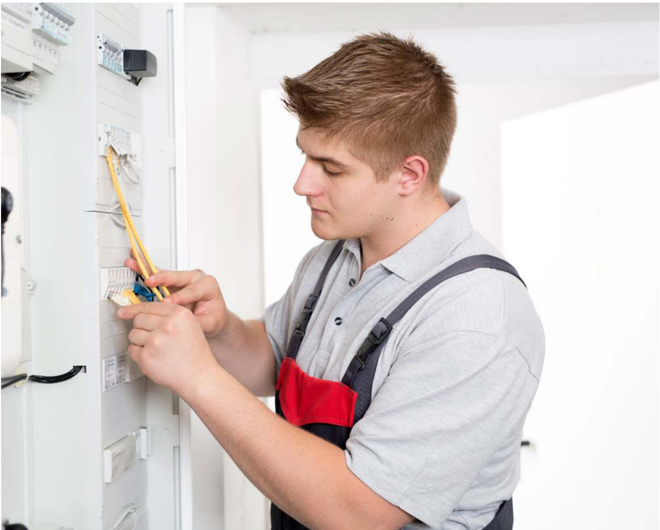
Abbildung 5: Überprüfen des Schaltschranks (Quelle: ZVEH)
