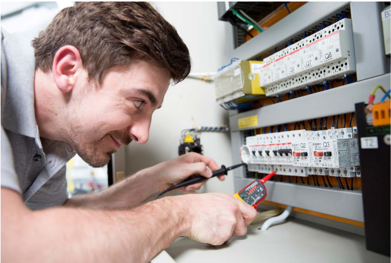
Abbildung 9: Messungen am Schaltschrank (Quelle: ZVEH)
